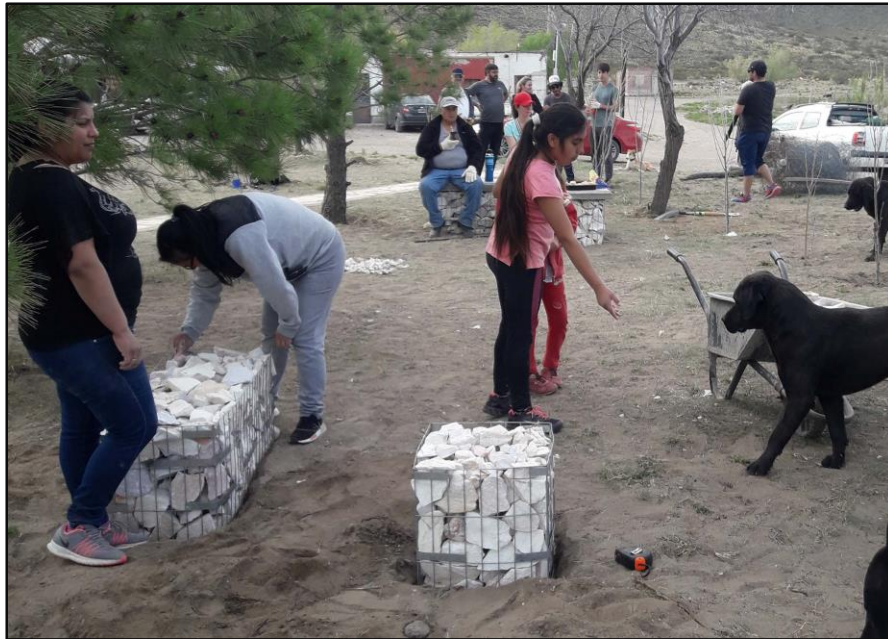
Proceso de armado del Equipamiento en la Plaza de los Pinos de Aguada de Guerra.
